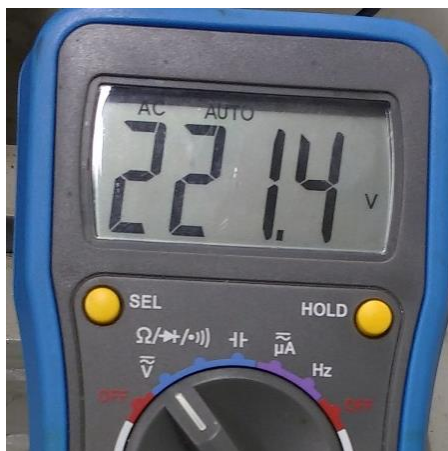
Fig. 10. Medição do valor da tensão terminal do gerador ajustado para o Set Point de 220V.
