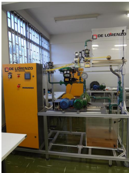
Fig. 8. Bancada do sistema de bombeamento.
