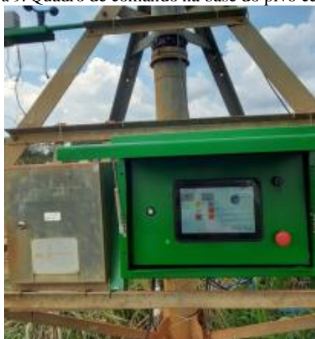
a) Quadro de comando
