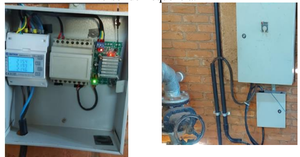
a) Multimetido de grandezas elétricas b) Quadro de comando do motor e multimetido
