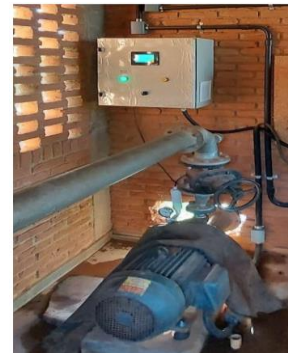
c) Conjunto motobomba e Inversor de frequência
