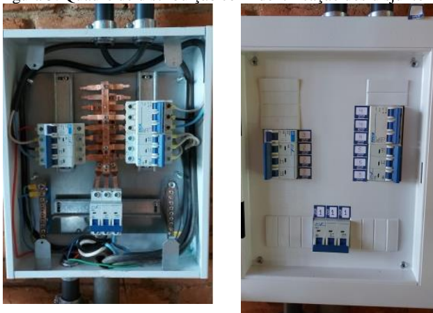
a) Visão interna do quadro b) Identificação dos disjuntores
