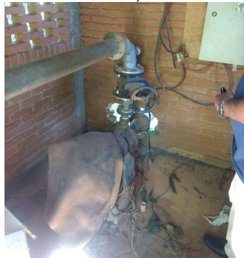
Figura 3: conjunto de acionamento hidráulico antes da modernização.
