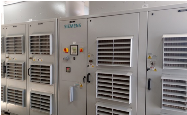
Figura 4 - Inversor de frequência para acionamento de motor na unidade EEAB.
