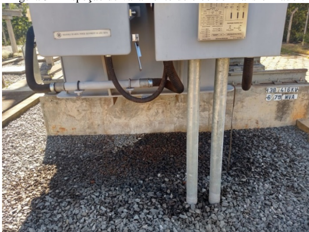
Figura 5 – Inspeção de vazamento de óleo do Transformador.
