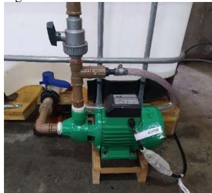
Figura 10: Bomba do circuito hidráulico
