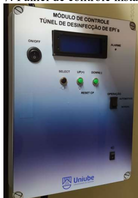
Figura 7: Painel de controle instalado
