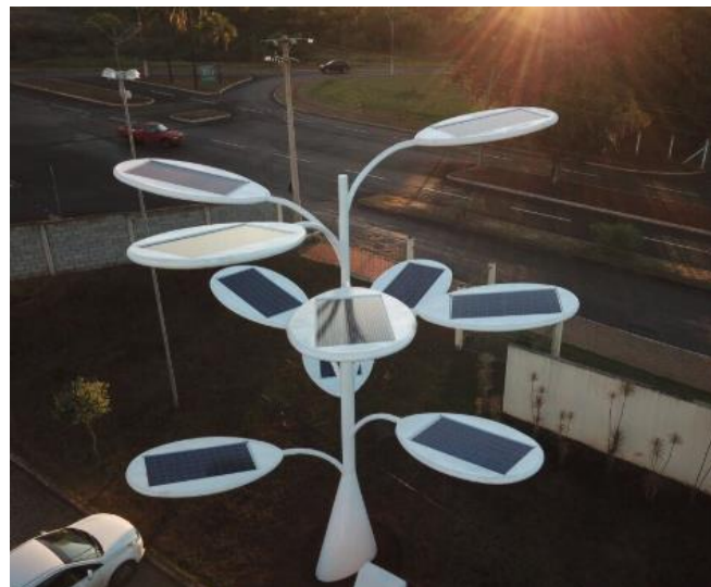
Figura 7 – Árvore Solar Instalada no Campus Itumbiara do IFG
