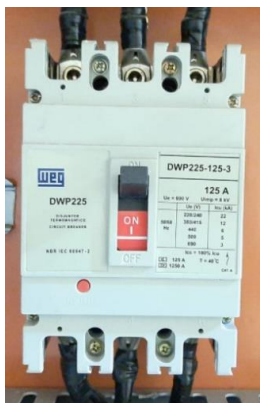
Figura 3: Disjuntor Geral do QGBT estudado
