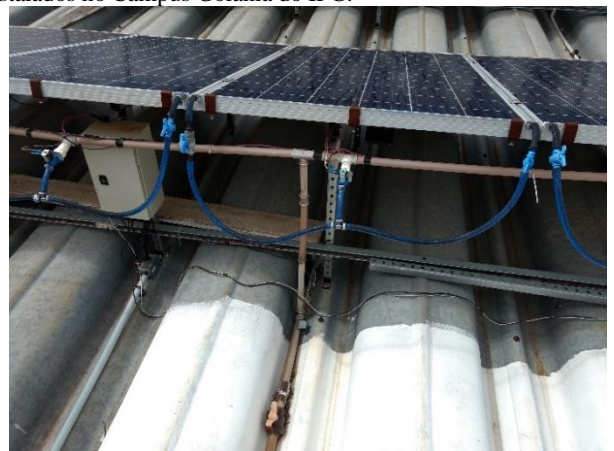
Figura 10: Sistema de arrefecimento de painéis fotovoltaicos instalados no Campus Goiânia do IFG.
