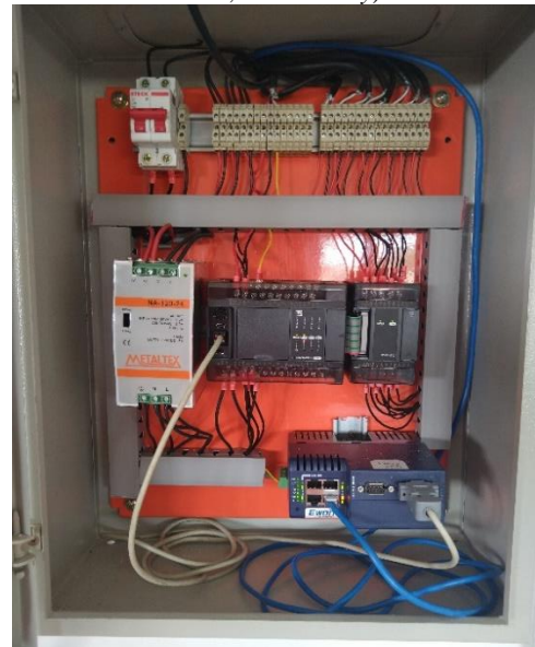
Figura 9: Vista interna do quadro com dispositivos (fonte de tensão, CLP e Flexy ).
