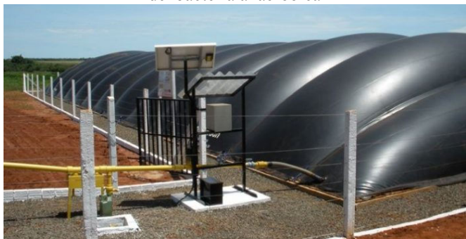
Figura 01 – Biodigestor tipo Lagoa Coberta com utilização de bactéria anaeróbica
