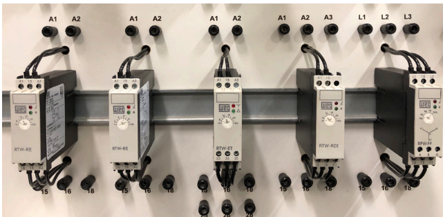
Figura 7: Relés temporizadores e de proteção dispostos na bancada.
