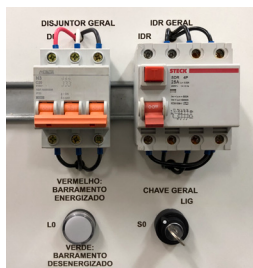
Figura 2: Elementos de proteção e seccionamento da bancada.
