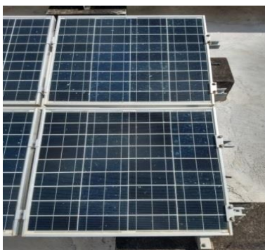
Figura 2: Placas em estruturas no telhado comum.
