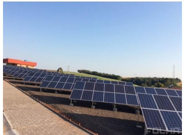
Figura 3 - Primeira usina solar do Rio Grande do Sul.
