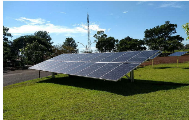
Fig. 2. SFCR instalado no campus do IFG em Itumbiara-GO.
