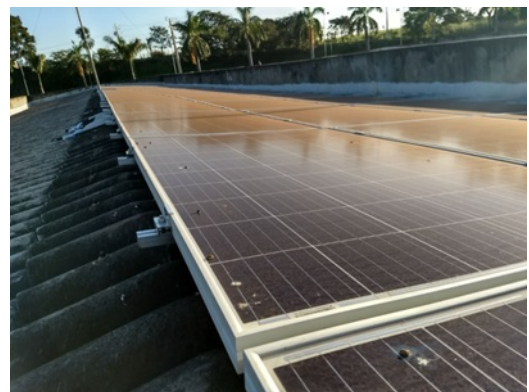
Figura 2: Sujeira registrada nos módulos do SFCR instalado no IFG/Campus Itumbiara.
