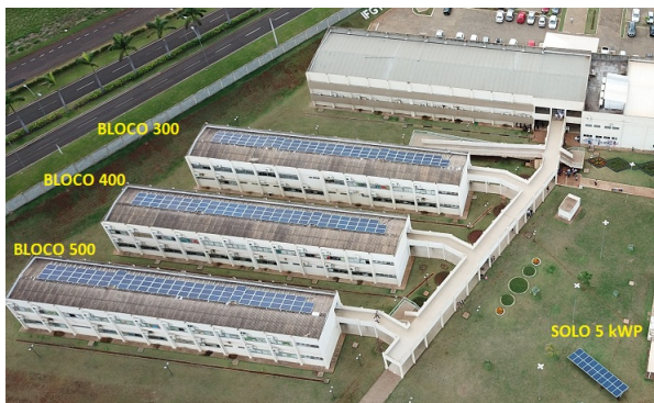
Figura 3: Gerador Fotovoltaico de 70,2 kWp Instalado no IFG/Campus Itumbiara.
