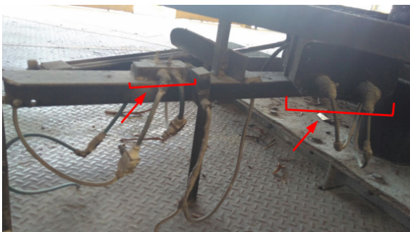
Fig. 11: Válvula e Transformador
